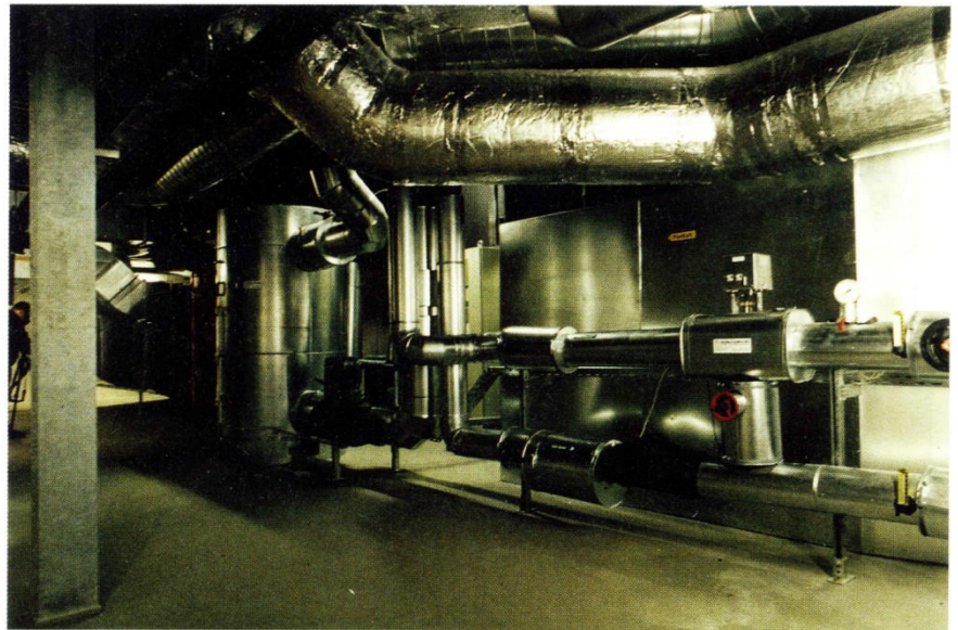
Die RLT-Zentrale Süd ...
