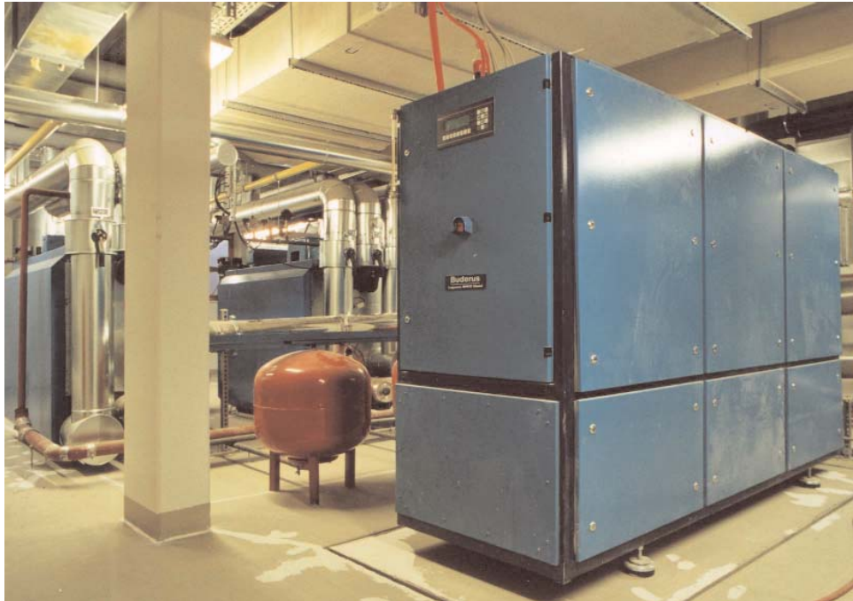
Blockheizkraftwerk in der Heizzentrale
