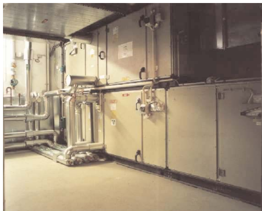
Das Zentralgerät in der Lüftungszentrale
