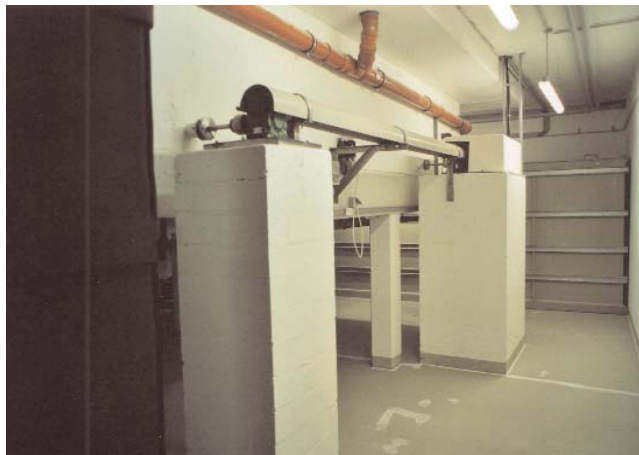
Motor für Hubboden unterhalb des Schwimmbeckens
